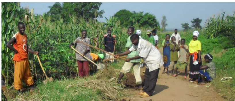
Cavando una zanja para canalizar el agua de la lluvia en el acceso a Tenga
